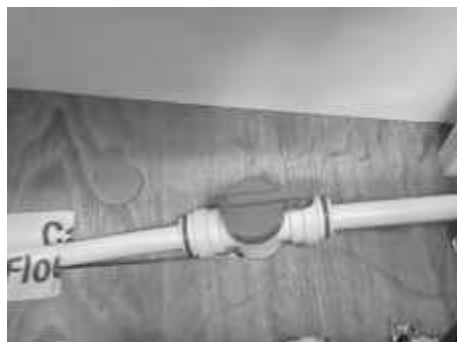
Bild 86: Ventil golvvärme ALDE
