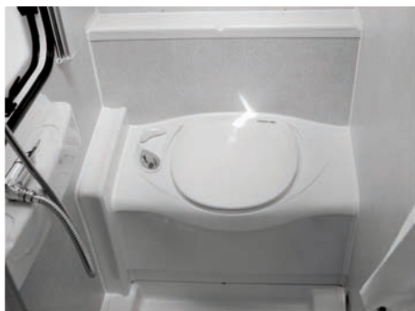
Bild 46: Toalett, exempel med fast installation
